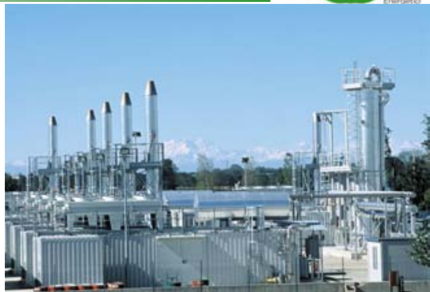
Impianto di Inzago – MI (6,6 MW)
