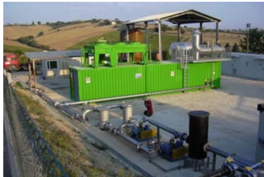
Impianto di Morrovalle - MC (1,3 MW)
